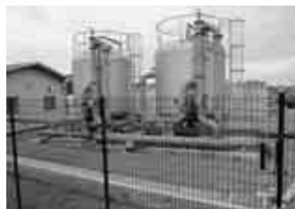
除鉄・除マンガン施設
