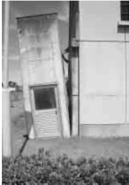
被災した吉田浄化センター
