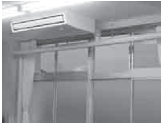
教室の窓側に設置されたエアコン 冷風は廊下側に流れる
