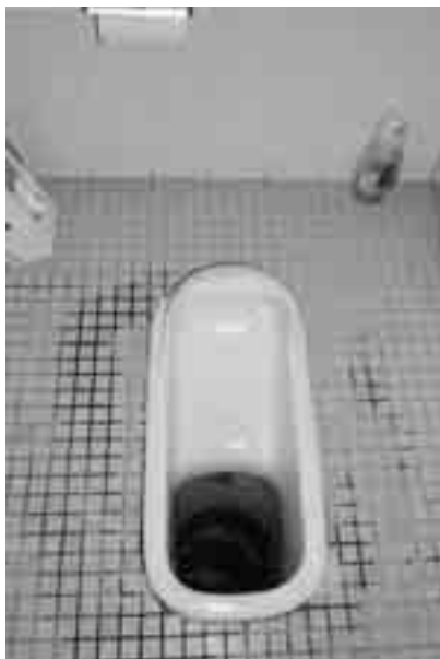
悪臭原因のポットン式トイレ
