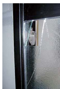
▲窓ガラスを割って人が不在の住宅内に侵入する「空き巣」
