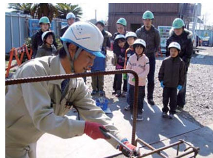
▲建設会社から工事の状況や鉄筋の結束する作業の説明を受ける参加者たち
