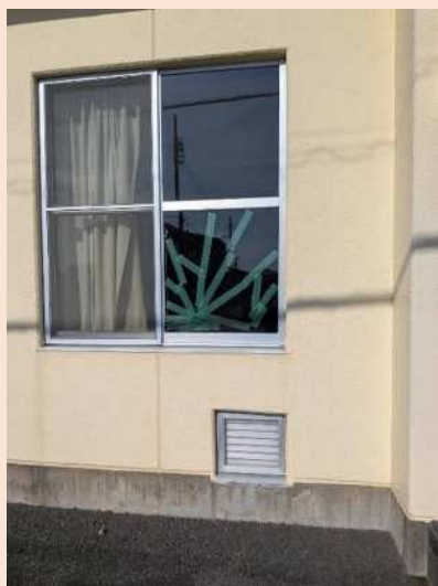
被害状況①(ガラスの破損)
