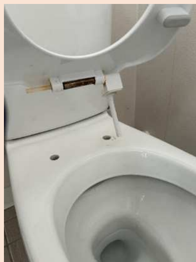
被害状況②(トイレの破損)
