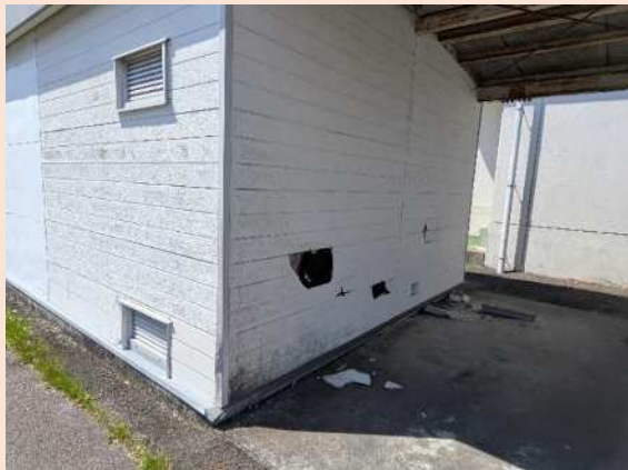
被害状況③(倉庫壁の破損)
