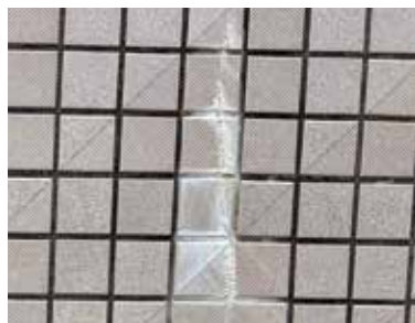
吉田町庁舎壁面のひび割れ
