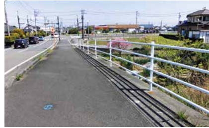
交通安全施設（防護柵）
