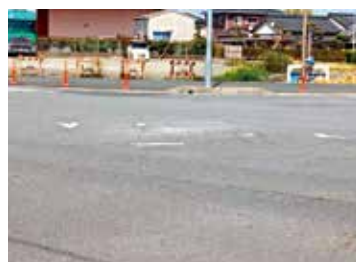
経年劣化した交差点中心標示
