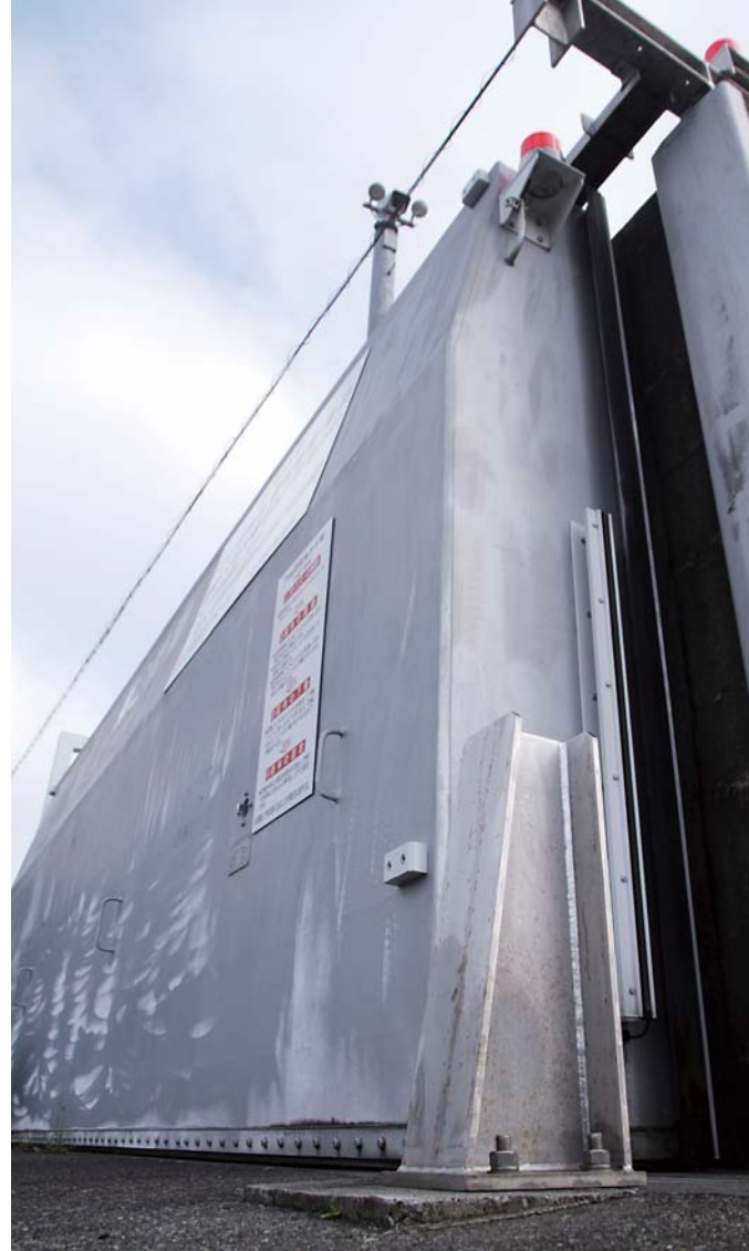
▲役場庁舎にある防災ステーションの整備により、一元的な遠隔操作制御が可能となった吉田漁港にある4基の陸こう
