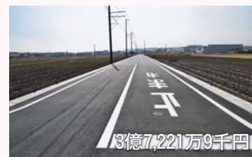
避難路整備 3億7,221万9千円 ▶ 安全かつ迅速に避難ができるように、狭い道路の拡幅や新規道路を整備 (町道舞台民附線ほか6路線)
