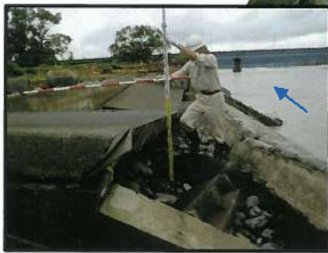
台風15号による護岸被災 (平成23年9月 島田市伊太地先)
