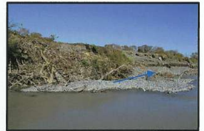
台風24号による護岸被災 (平成30年10月 焼津市西島地先)
